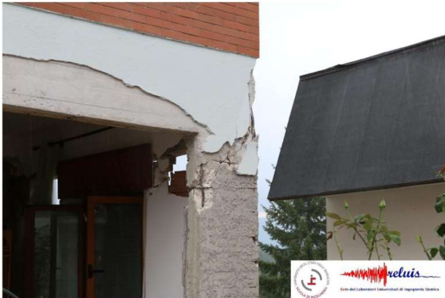
Particolare del danno ad un nodo trave-pilastro
