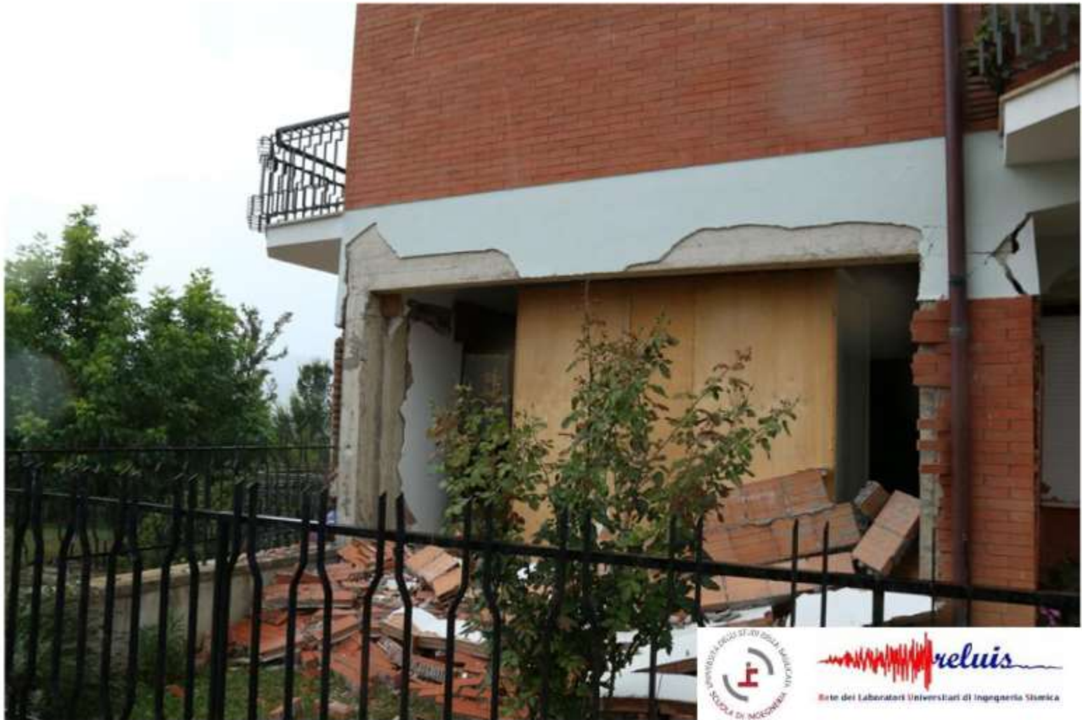
Danno alle tamponature
