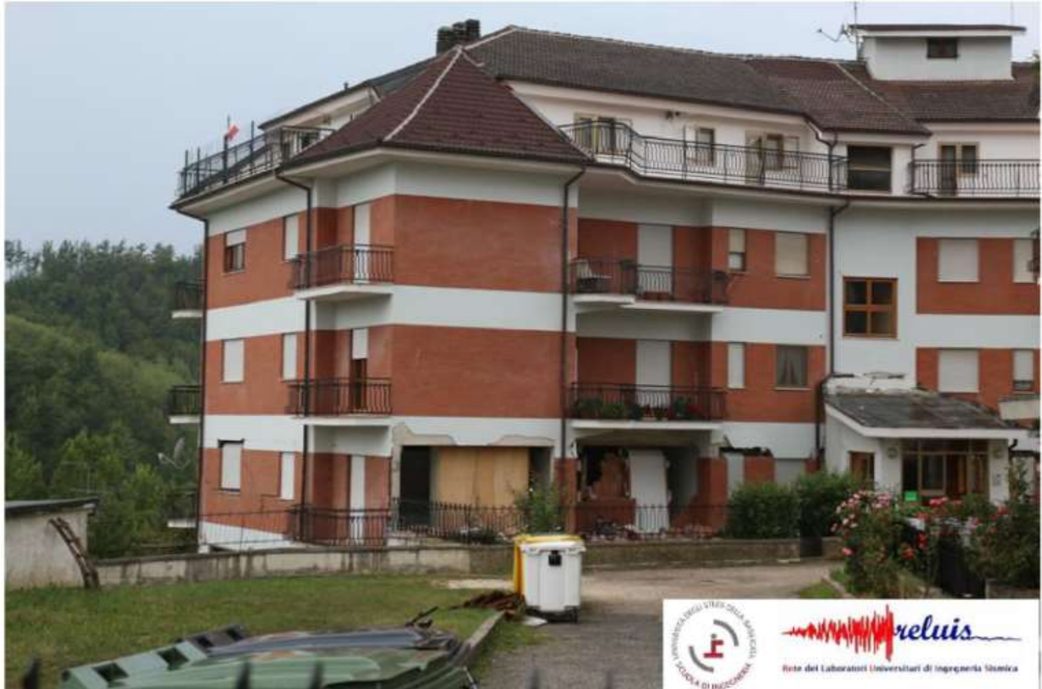
Danno alle tamponature
