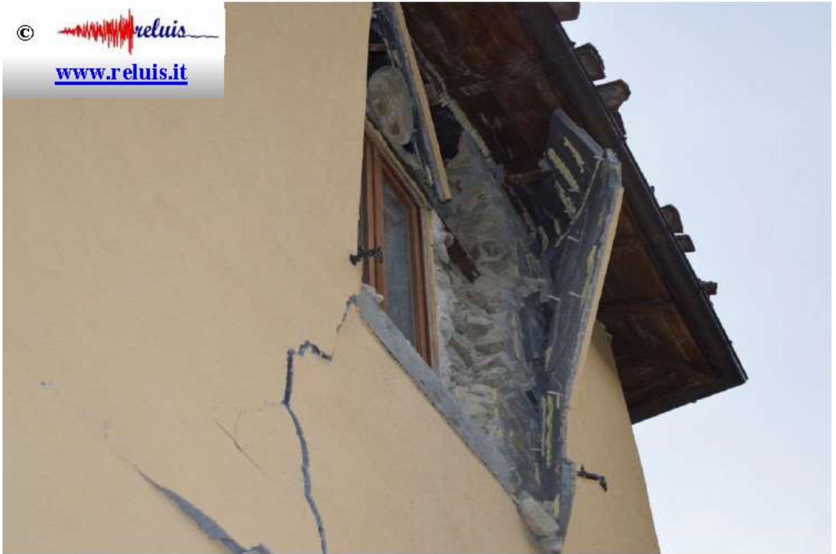
Edificio in muratura – Illica (frazione di Accumoli) Particolare del distacco di elemento non strutturale (cappotto termico).
